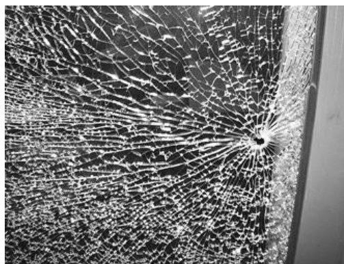
图26：浮法玻璃碎裂后粘连
